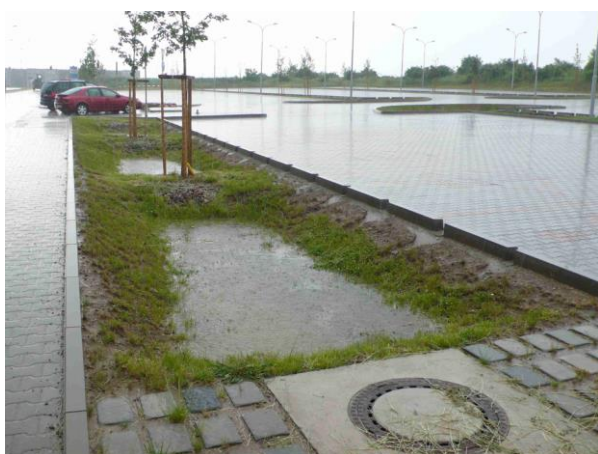
Obr. P32. Vsakovací průlehy s retenční rýhou k odvodnění parkoviště podél ulice Akademické (Foto: JV PROJEKT VH s.r.o.)
